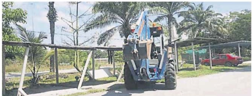
士拉央市议会将非法筑起的有盖停车位拆除。
